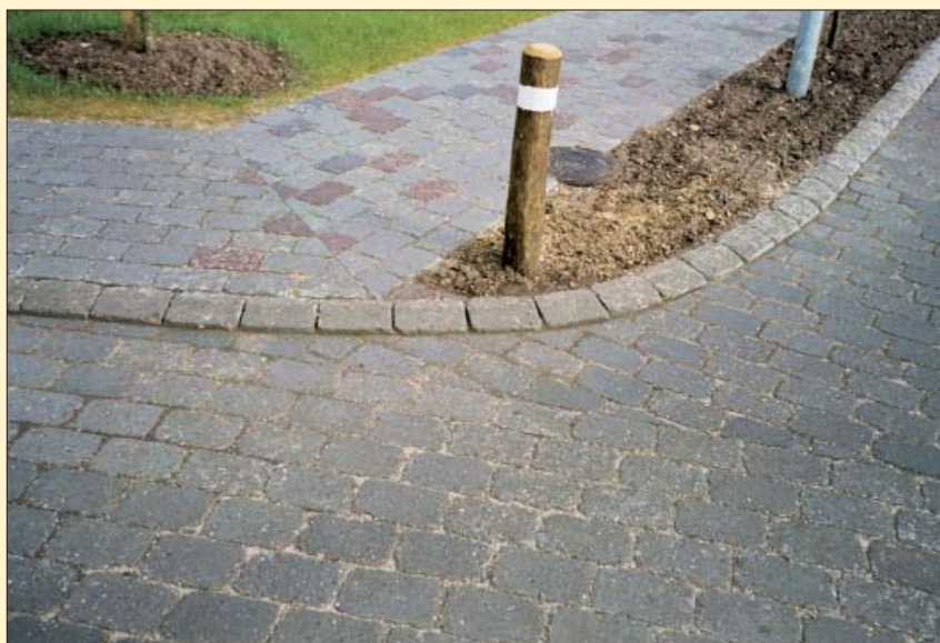
I denne belægning har der været gravet op for at reparere telekabler. Ved en omhyggelig og korrekt retablering kan det gøres uden ar i belægningen.
